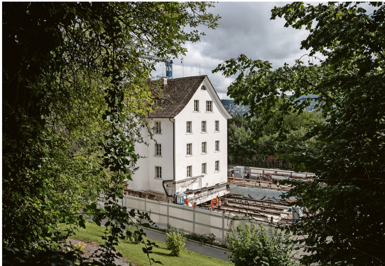
Auf Schienen und mit Hydraulikpumpen wurde die 1800 Tonnen schwere Villa Blumenthal gestern seeabwärts verschoben.
