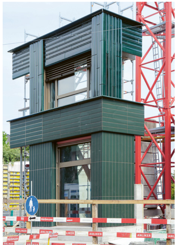
Mockup der Fassade
